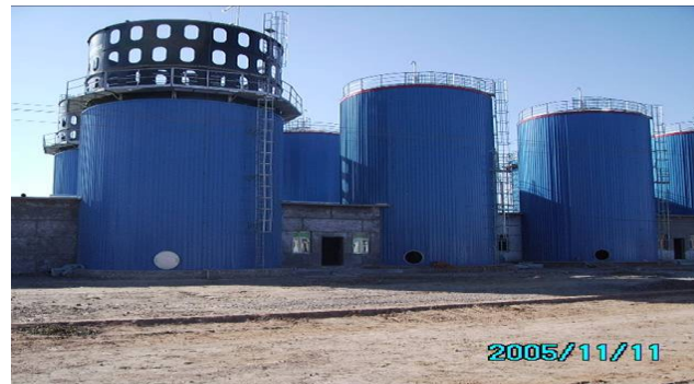
8个容积为675立方米厌氧发酵罐
